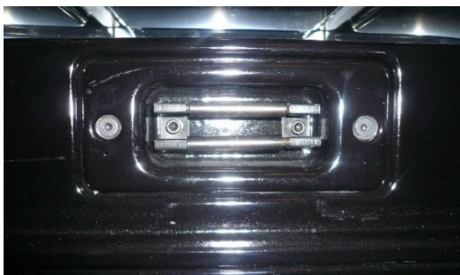
Figura n°27 - Accessi per la pulizia dello scarico fumi.
